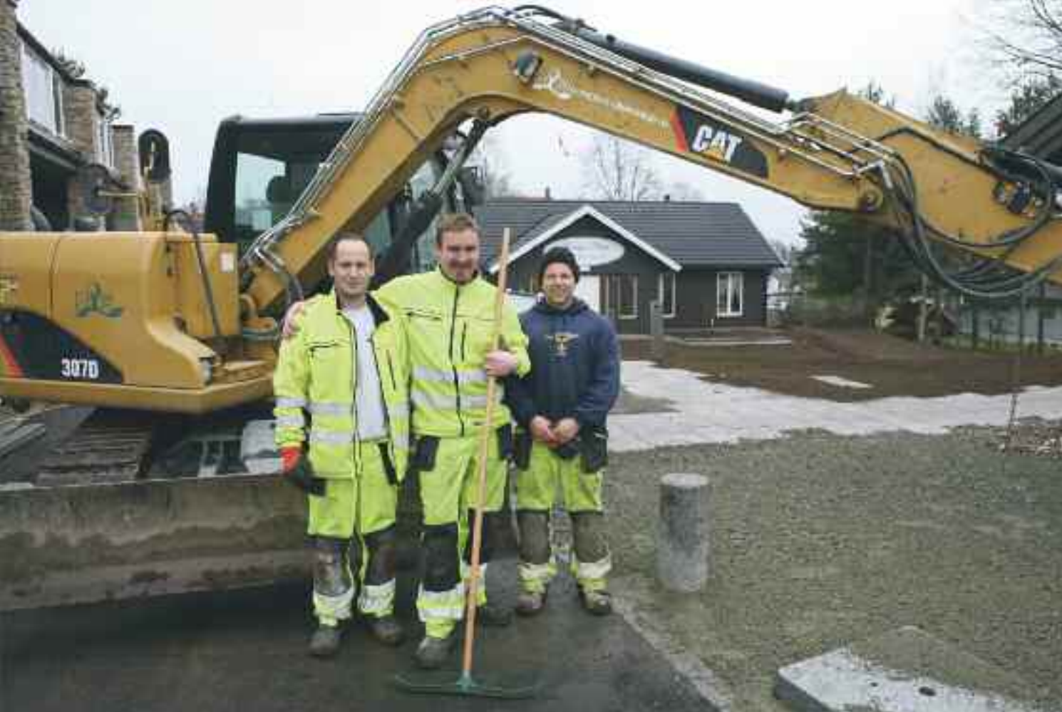
Grøntarbeidene på det nye Sundbytnet i Jessheim ble avsluttet i begynnelsen av november, fra venstre Gregor Dubziak, Carl Axel Søndena og Ola Lindsveen.
